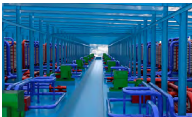
Interior edificio de ósmosis inversa
