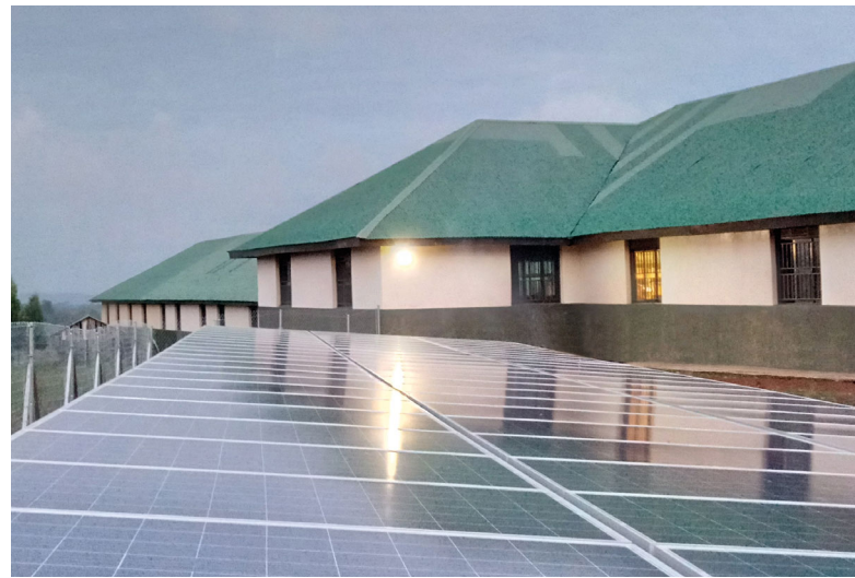
La instalación de placas solares han permitido, en UNILAC, el acceso permanente a internet
