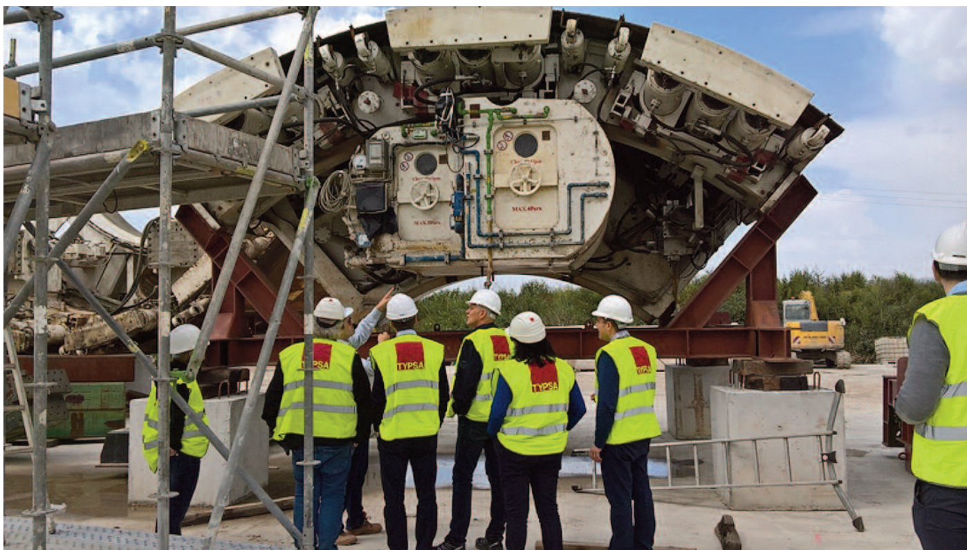
Ensamblaje de la tuneladora EPB para el nuevo acceso ferroviario a la terminal del Prat en Barcelona
