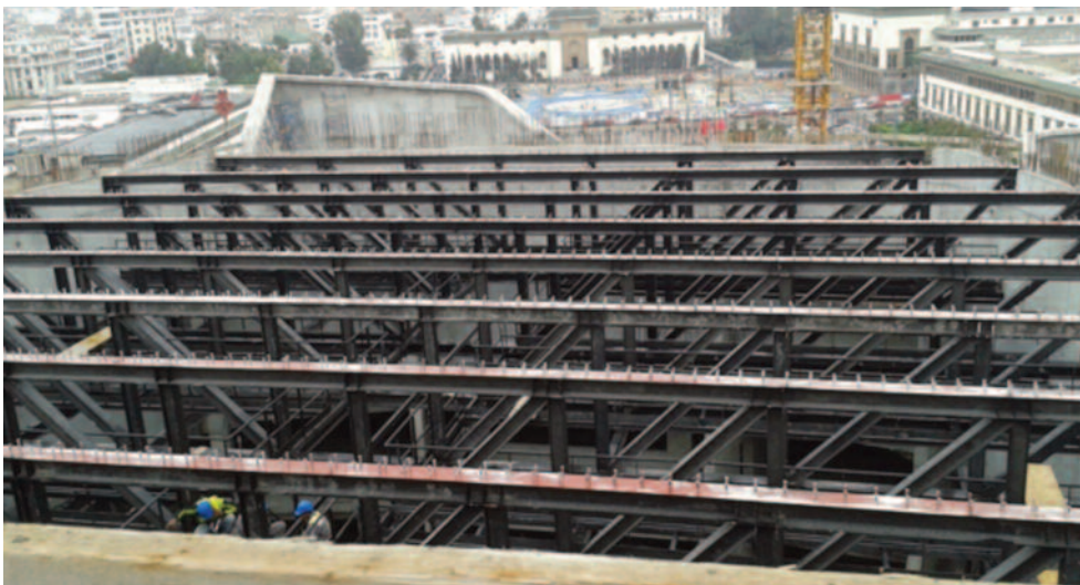
Gran Teatro – vistas de las cerchas mixtas de cubierta, por encima de la sala
