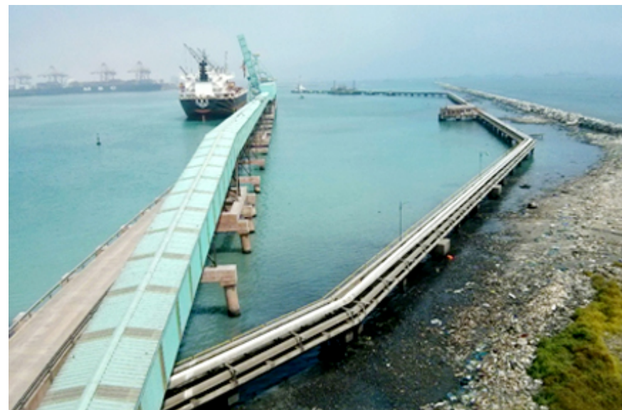
Vista del rompeolas norte del puerto y el nuevo muelle de minerales
