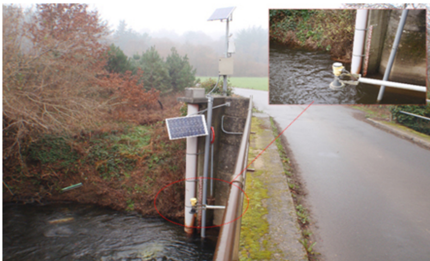
Estación de aforo 520-Tambre
