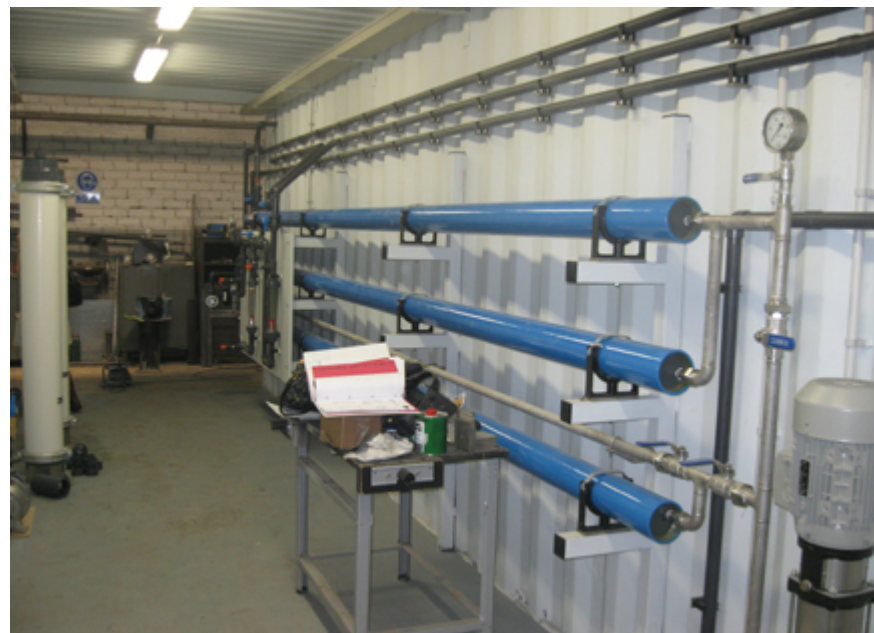
Proceso de regeneración de agua depurada
