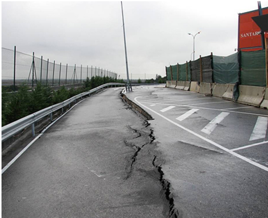
Fisuras en el pavimento del trasdós del muro en Febrero de 2009
