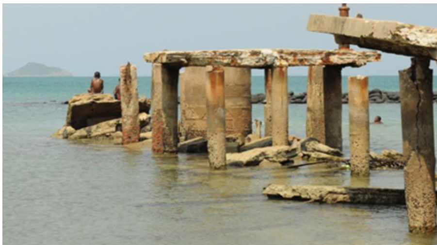
Estado estructural de uno de los muelles
