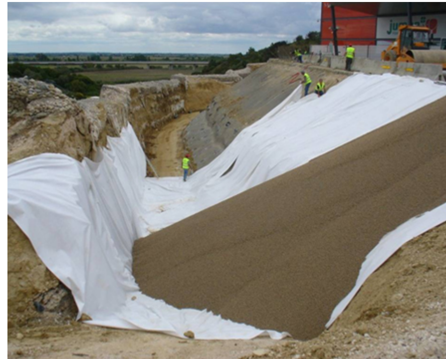
Actuaciones de descarga del trasdós del muro durante los primeros meses de 2009
