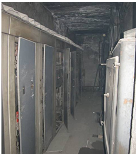
Sala de control del túnel sin mantenimiento
