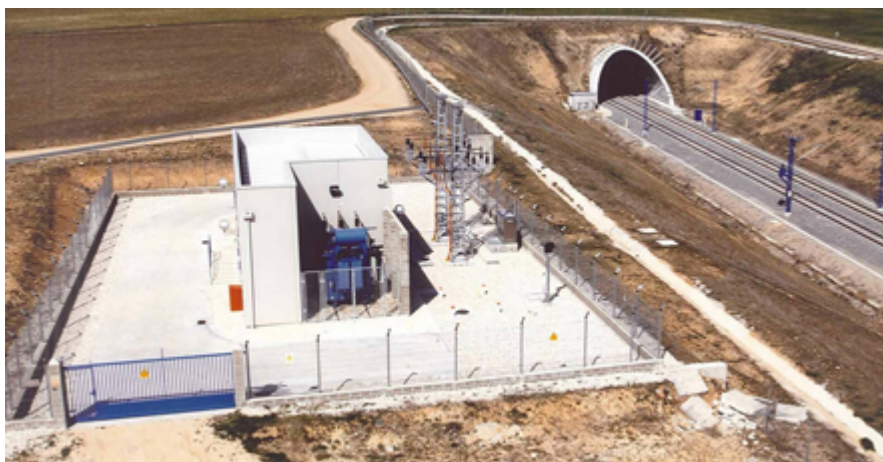
Centro de Autotransformación
