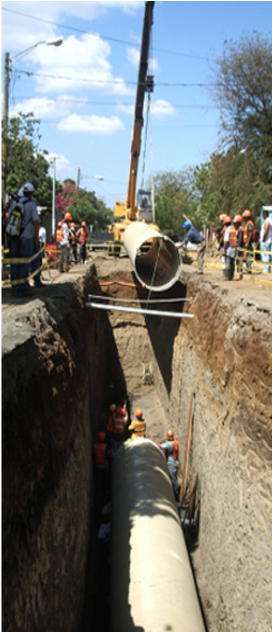
Sistema de intercepción para las aguas residuales de Managua
