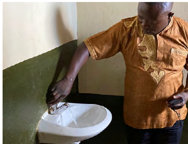
Suministro de agua potable en UNILAC
