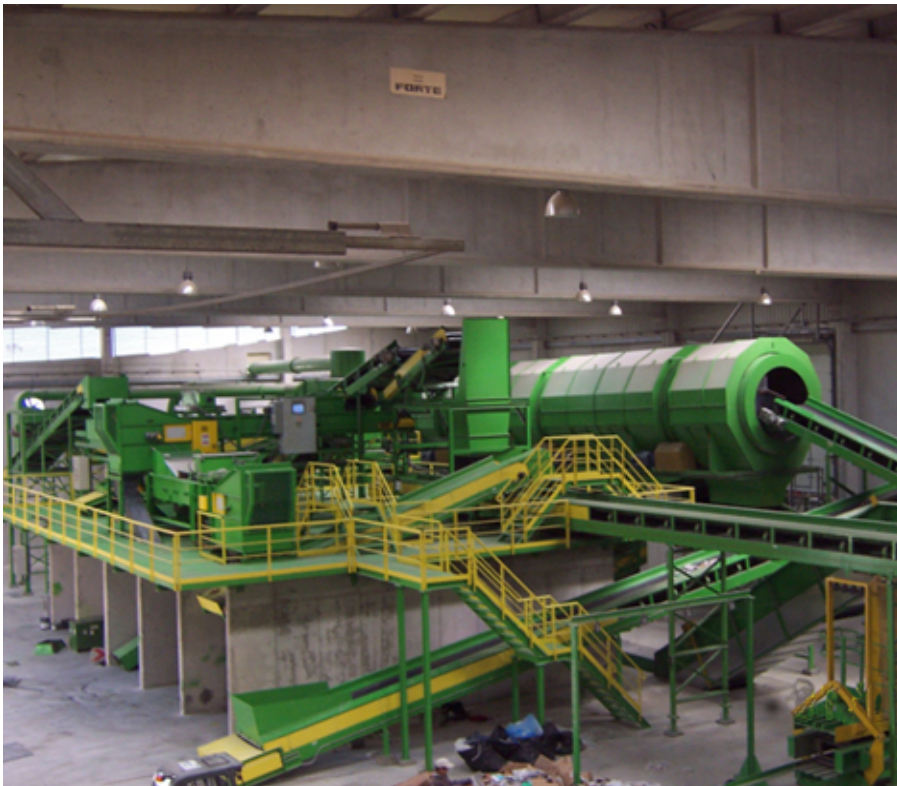
Vista general de la nave de clasificación granulométrica, con el tromel de 24 m
