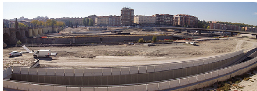
Imagen del río a la altura del Puente de Toledo, tras el soterramiento
