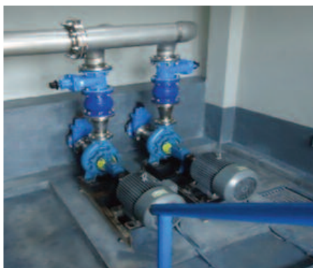
Sistemas de bombeo
