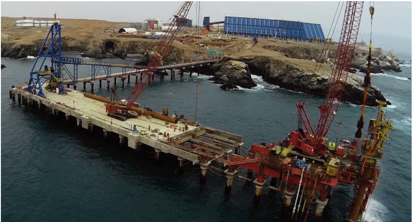
Vista de la construcción del nuevo muelle mediante el sistema de avance con Cantitravel; a la izquierda un Shiploader en fase de montaje
