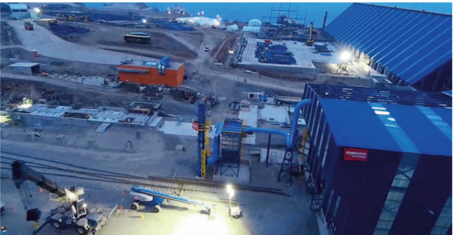
Vista parcial de las obras en construcción con sus instalaciones. En primer plano el edificio para recepción del concentrado de cobre por tren. Más allá se observa la base para un almacén por construir y a la derecha otro almacén para 150.000 t
