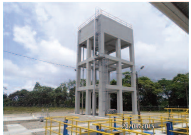
Tanques de almacenamiento
