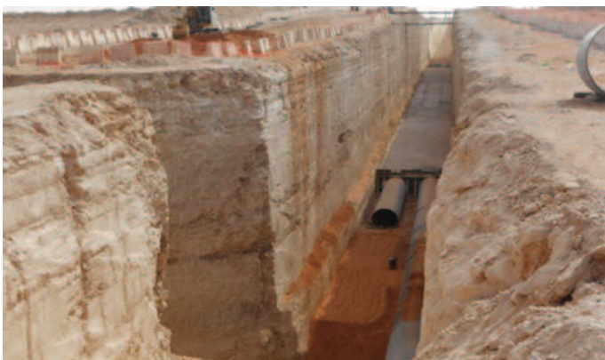
Detalle de conducción de acero al carbono
