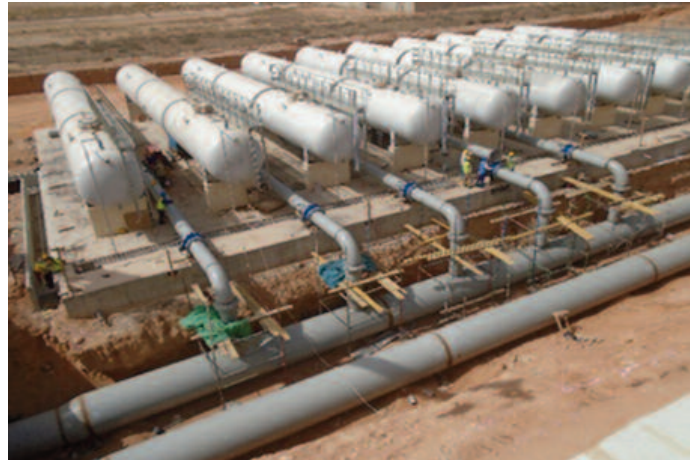
Detalle estación de calderines
