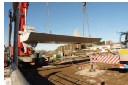
izado de la primera pieza metálica del puente para su colocación sobre el estribo Zorrotzaurre
