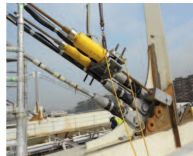
Disposición de gatos hidráulicos sobre el terminal inferior del tirante para su tesado
