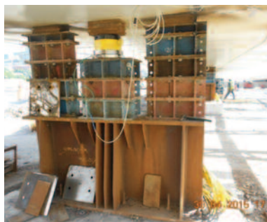
Detalle del gato de izado y célula de carga bajo apeo provisional
