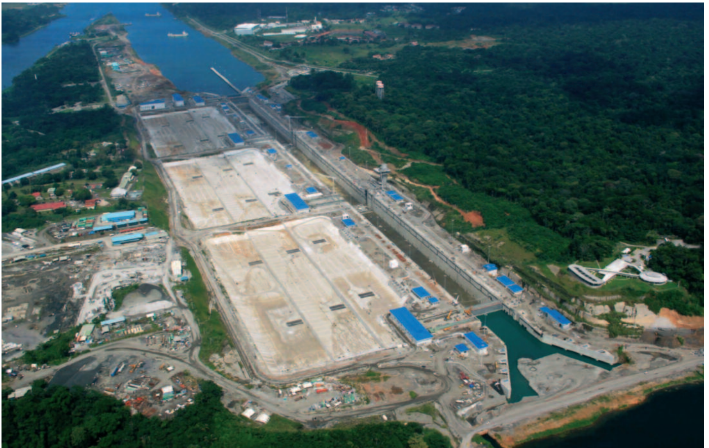
Nuevo juego de esclusas del lado Atlántico. Los edificios de la ampliación destacan en la imagen por su significativa cubierta azul (Diciembre de 2015)
