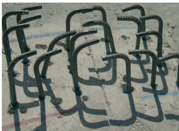
Arranque de las barras de acero utilizadas para las vigas de hormigón
