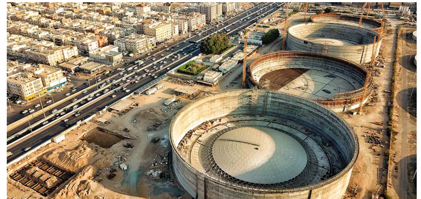
Abastecimiento de la ciudad de Riyadh
