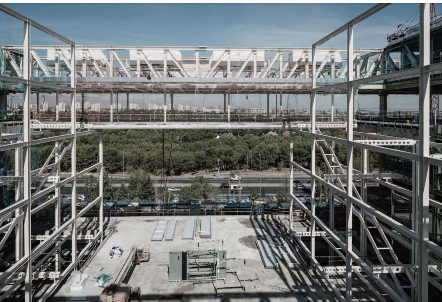
Puente norte con electrogeneradores apoyados sobre bancadas integradas en la estructura de cubierta (@Arquitectos Ayala)
