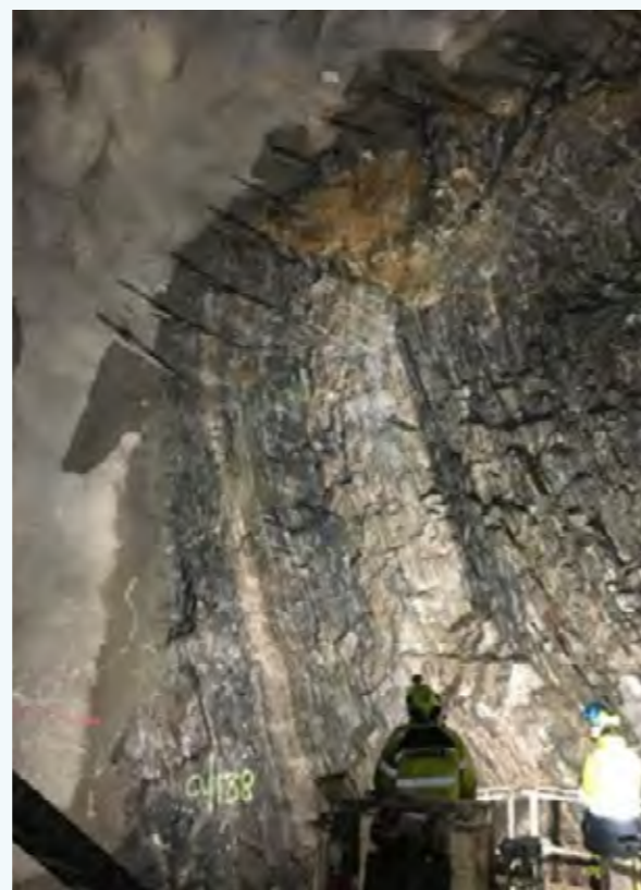
Frente de excavación del túnel de acceso de Londonviadukten / Londonviadukten access tunnel face
