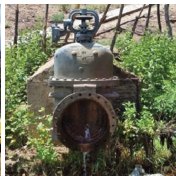
Liberação para jusante - comporta Stop-Log
