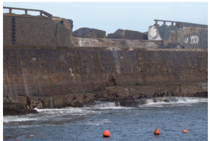
Rotura del espaldón. Temporal del 9 de febrero de 2016
