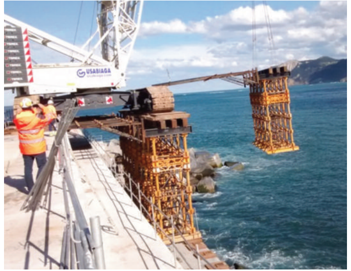
Movimiento de los módulos de la cimbra para el avance de la grúa por el dique
