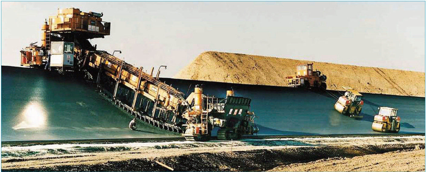
Asfaltado de las curvas del óvalo de alta velocidad. Fuente: SMB Strabag – Max Bögl1
