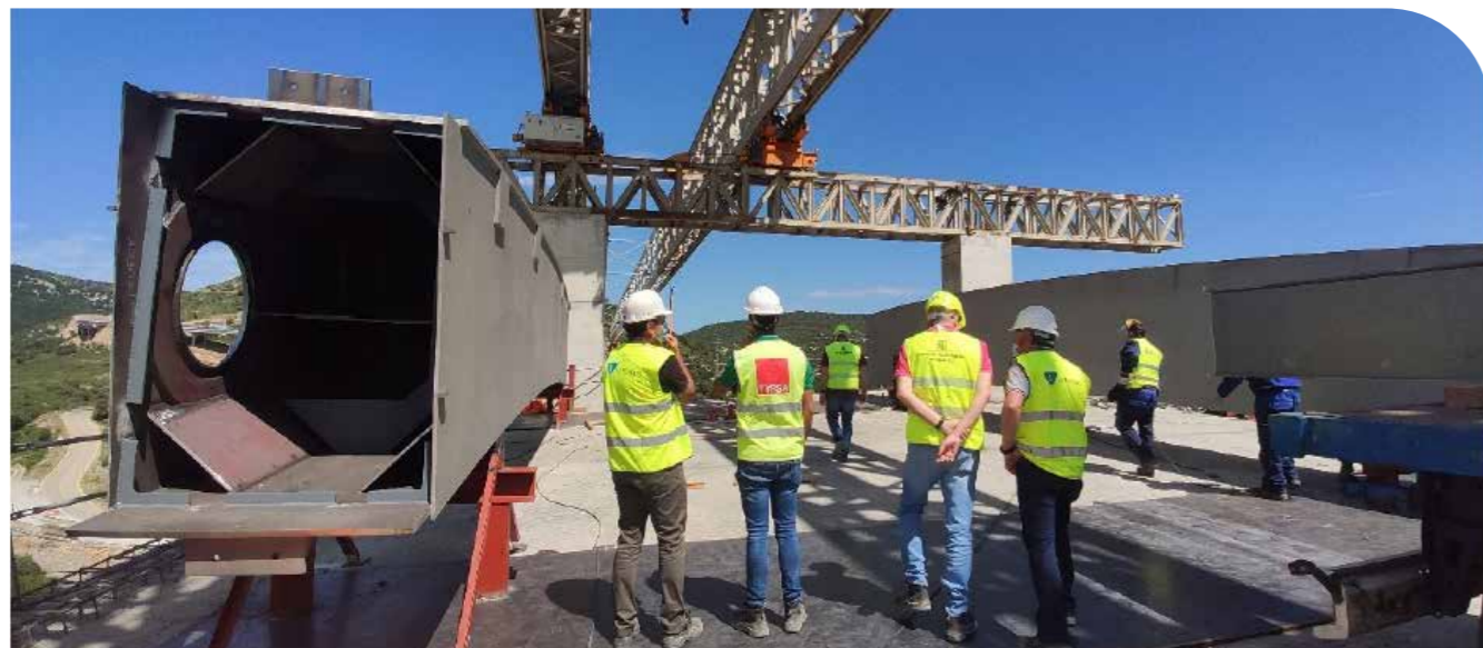
Uno de los cajones dispuesto en la bancada de montaje en obra
