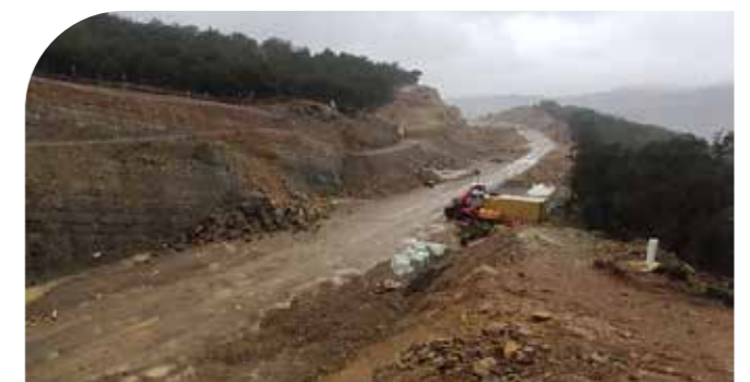
Inestabilidad producida por intercalaciones margosas
