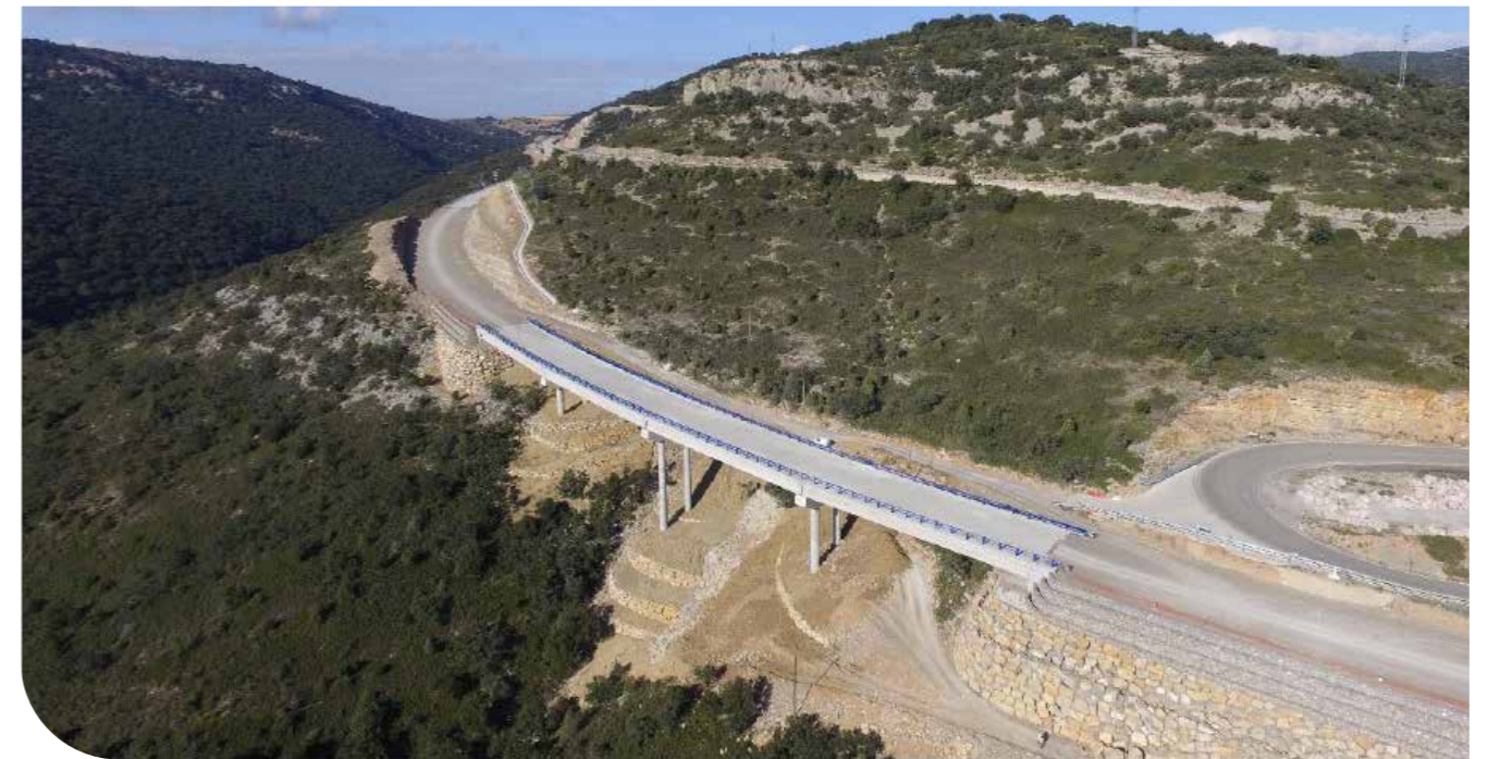
Vista general Viaducto 2.4. Acondicionamiento fondo de vaguadas y muros ecológicos en ambos estribos
