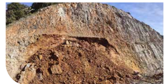
Inestabilidad producida por un relleno cárstico
