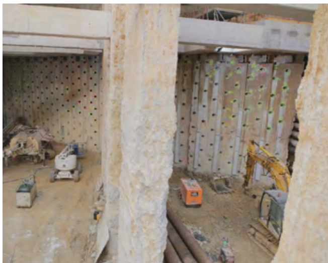
Pantalla testera bajo plataforma de tubos de D1100 mm. Perforada para realizar columnas horizontales de consolidación del terreno
