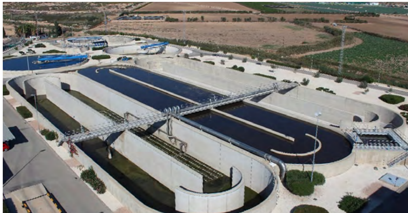
Vista aérea de la EDAR de Los Alcázares, en la zona del Mar Menor, tomada mediante dron
