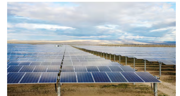
Bacon solar plant, USA
