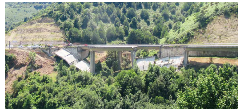
Siniestro de los vanos 1 y 3 del viaducto del Castro, sentido A Coruña, España
