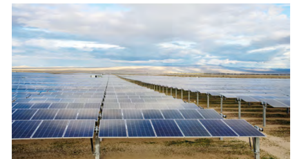
Planta solar Bacon, EE. UU.
