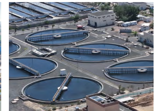
Planta depuradora de Madinah-3, Arabia Saudí
