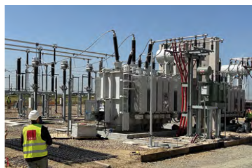
Subestación eléctrica del parque solar de Los Alcores, Sevilla
