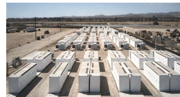
Proyecto stand-alone "Condor", con baterías de ion-litio, California, EE. UU.
