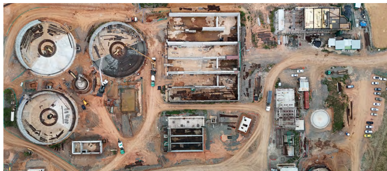
Construcción de la planta de tratamiento de aguas residuales de Arraiján Este, Panamá
