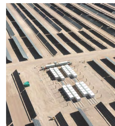
Sistema de baterías de la planta Andes Solar IV, Chile
