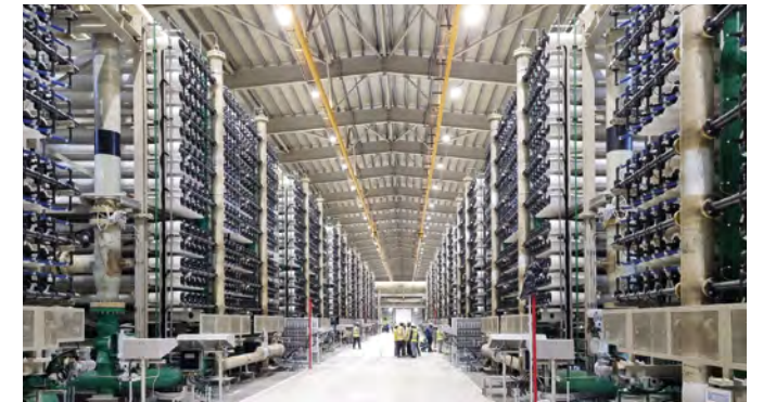
Planta desaladora de Yanbu 4, Arabia Saudí
