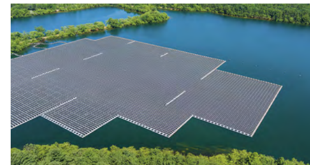
Planta solar flotante
