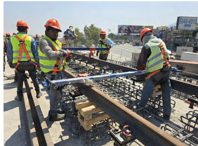
Ampliación del ferrocarril suburbano entre la estación de Lechería y el Aeropuerto Internacional Felipe Ángeles, México
